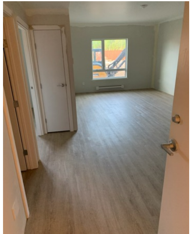
LVL 1 EW Suite Progress
